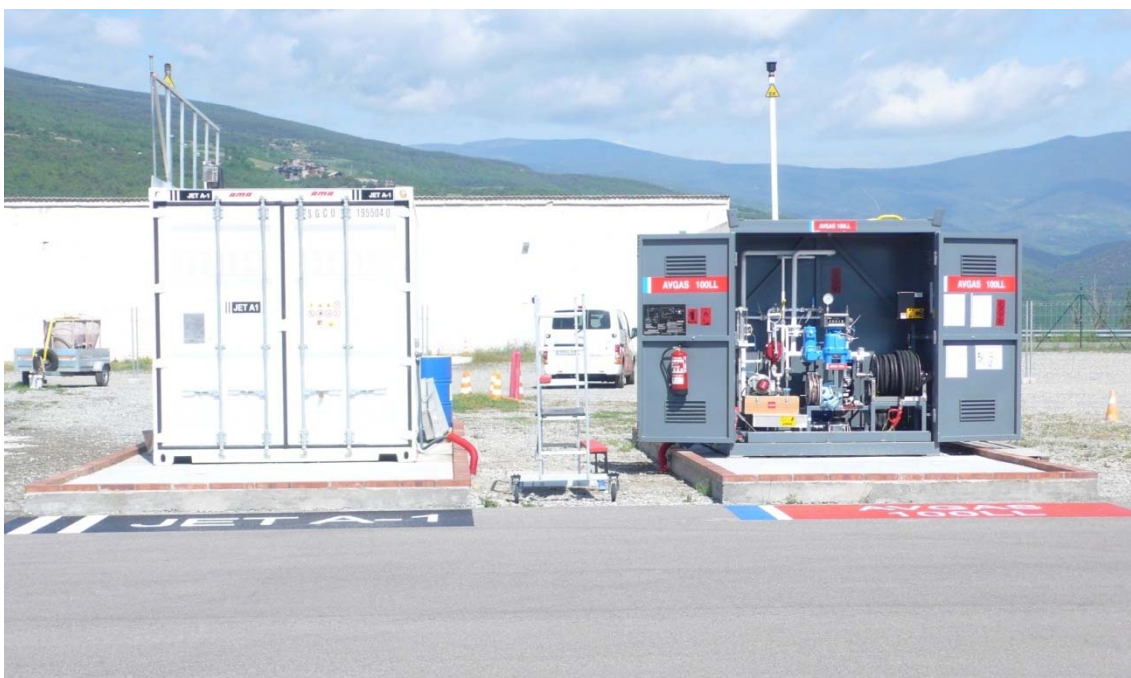
Figura 80. Zona de subministrament de combustible
