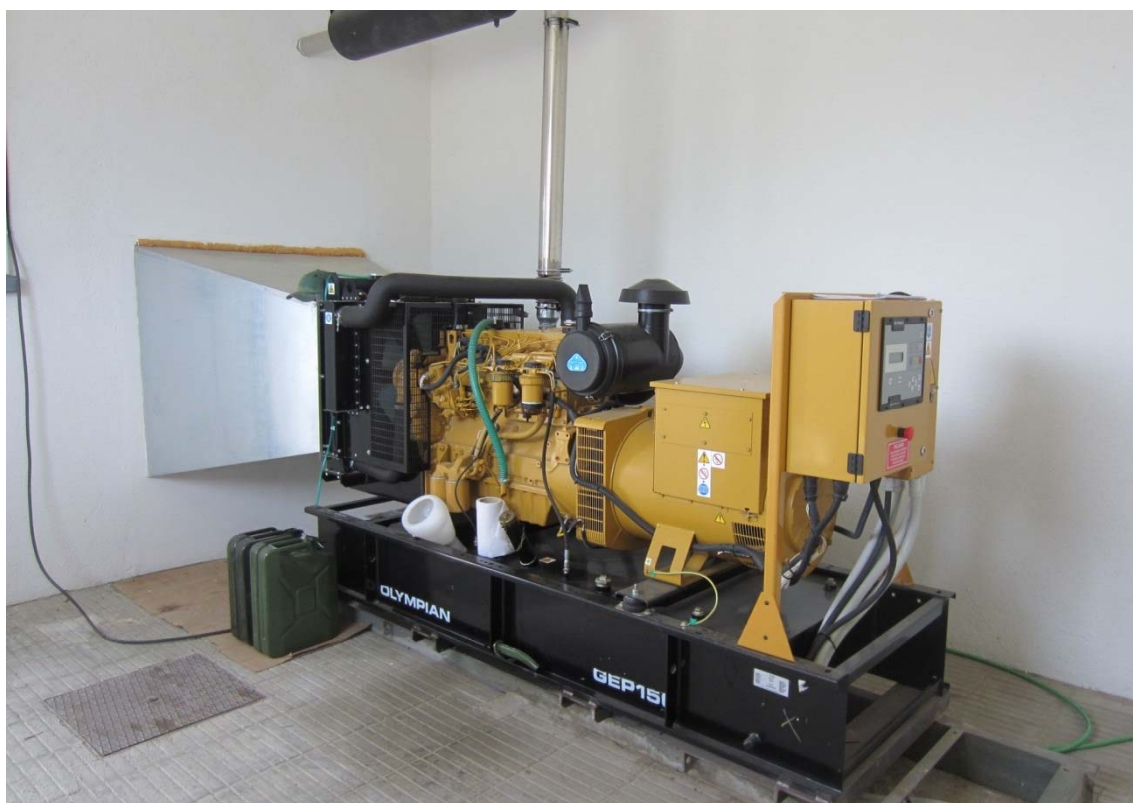
Figura 83. Generador dièsel a l'interior de la central elèctrica
