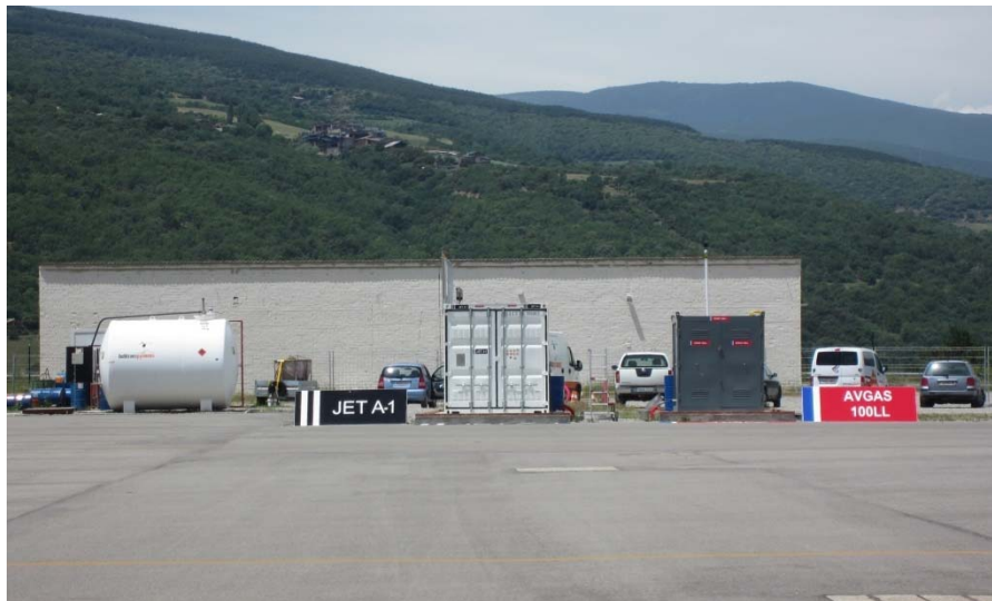
Figura 12. Dipòsits de combustible
